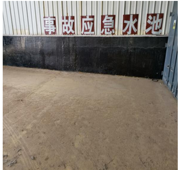
仓储内地埋式事故应急池
