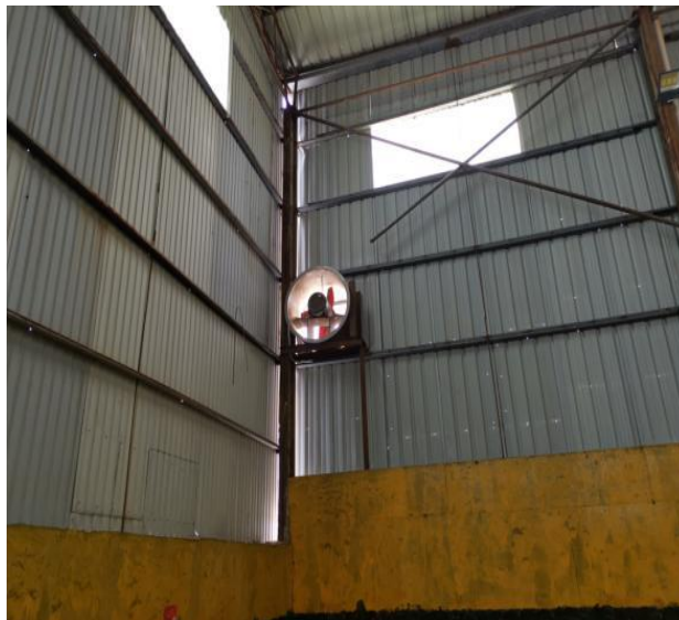
仓储内部通风换气扇
