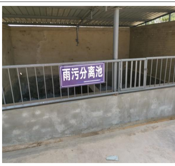
项目区雨污分流池
