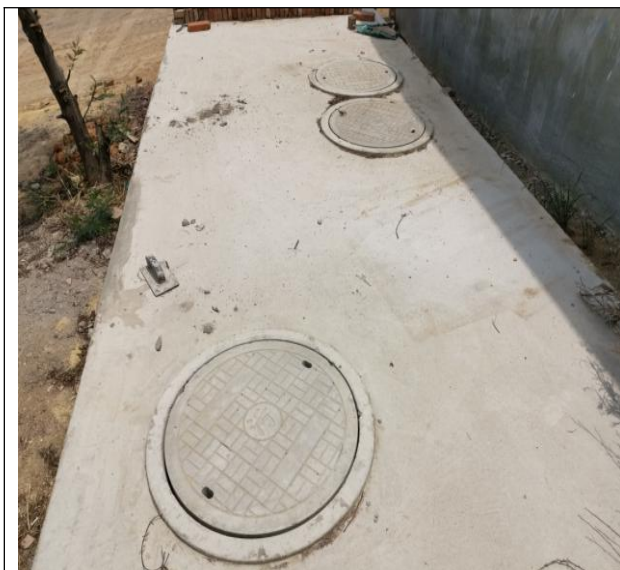
项目 50m 3 地埋式化粪池
